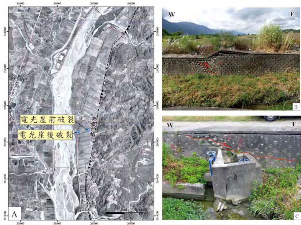
圖十、A：電光地區地表破裂位置圖。B：地形崖前緣逆衝破裂。C：距B處破裂東側約260公尺，亦有逆衝破裂之現象。
