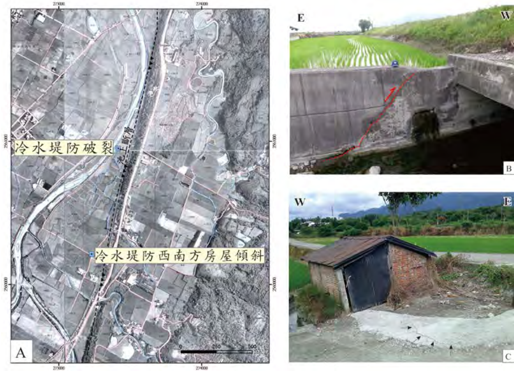
圖七、A：富里南端冷水地區地表破裂位置圖。B：冷水堤防逆衝破裂。C：冷水堤防西南方農舍向西傾斜，黑色箭頭指向為路面破裂。
