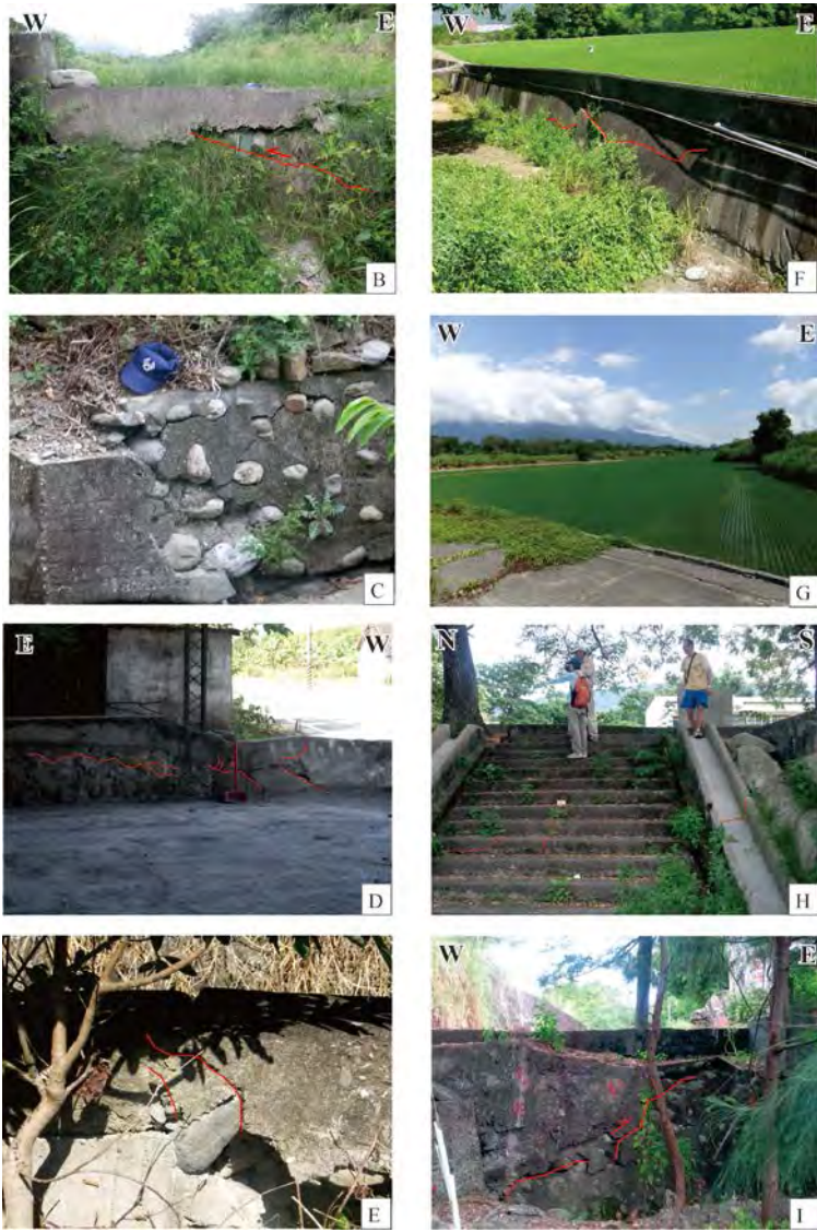
圖八、B：建安宮東側逆衝破裂。C：公頂山破裂。D：靈公祠內圍牆擠壓破裂。E：靈公祠西北側溝渠破裂。F：靈公祠東北側溝渠破裂。G：法林寺西南側凹谷(可能與斷層活動有關)。H：萬安國小內地形崖上之滑梯破裂。I：萬安國小圍牆背衝破裂。
