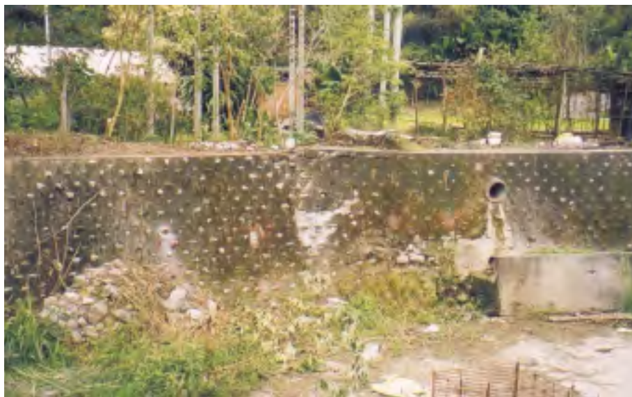
圖三 池上斷層之地表露頭照片。a. 公路旁擋土牆上有逆衝斷層式的破裂面，地點在大坡村前之上坡道路旁。b. 排水溝護坡呈現逆衝斷層式的破裂面，地點在錦園村北之排水溝。
